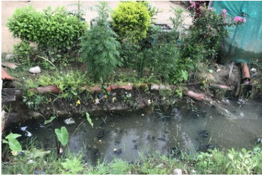
雨水や家庭の排水が側溝に溜まる
