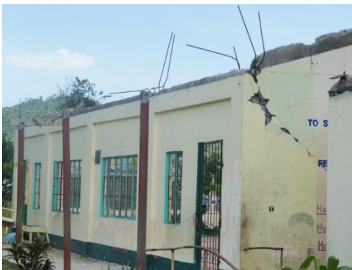
台風により屋根が破損した小学校の校舎
