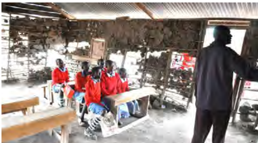
支援地域の小学校の様子。壁が崩れかけています
