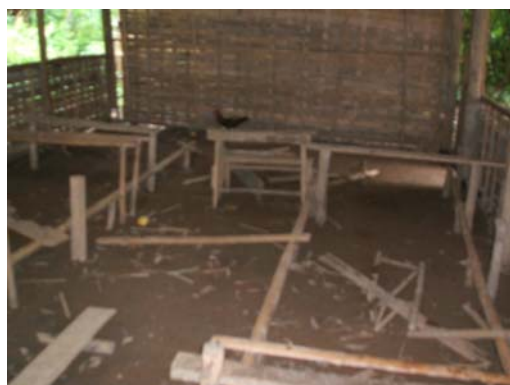
村の小学校内部（机、椅子が壊れたままになっている）
